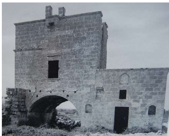
FIG.12 -Territorio di Presicce. Complesso edilizio di S. Riggio prima del crollo.
