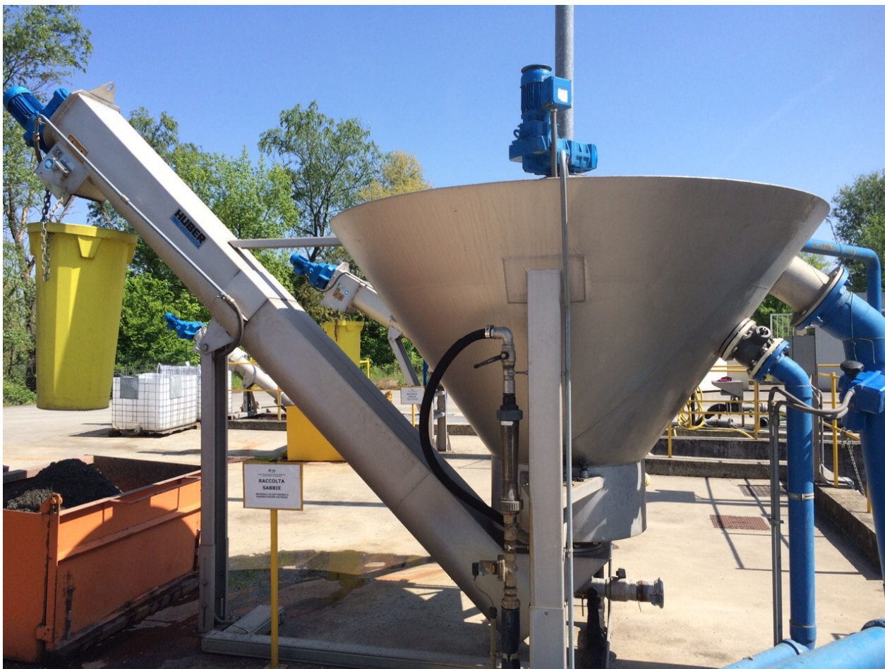
Figura 2. Impianto di lavaggio delle sabbie (sezione comparto ricezione rifiuti "Bottini").
