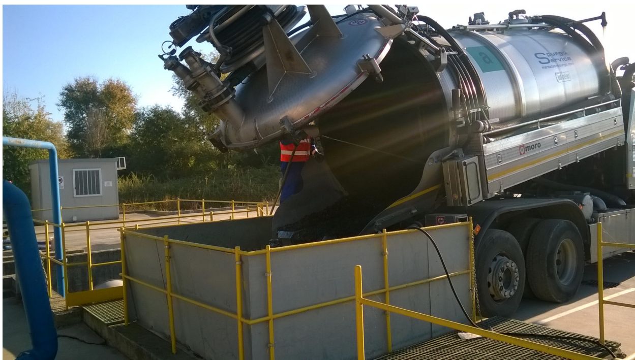
Figura 1. Impianto Bottini per la ricezione e il trattamento di rifiuti liquidi.
