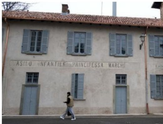
Gli operai al lavoro sull'intonaco della facciata principale hanno scoperto la scritta
