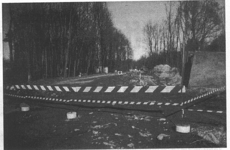
I lavori per la costruzione della rete fognaria lungo la strada per Corgeno (Foto M. Fumagalli)
