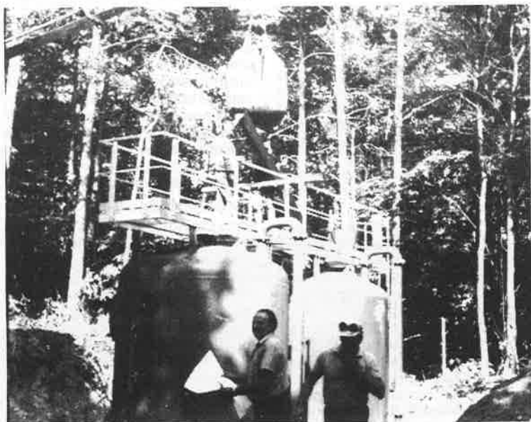
L'impianto di trattamento dell'acqua potabile dotato di filtri e carboni attivi per la rimozione dei solventi clorurati. È stato installato a salvaguardia dopo che una falda inquinata di Daverio aveva marginalmente toccato il territorio di Vergiate. Costo 50 milioni
