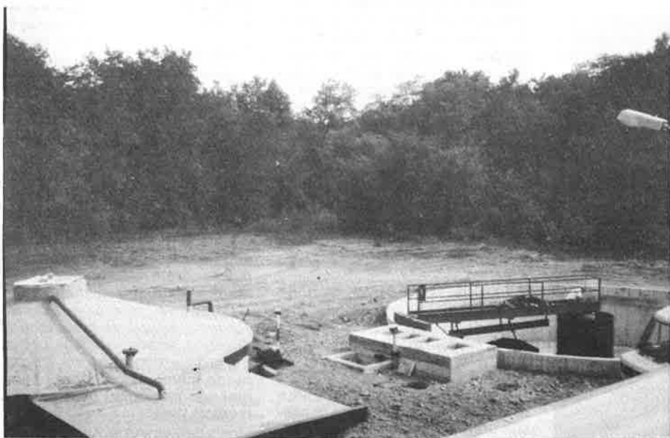
Il nuovo depuratore di Vergiate è quasi pronto. Sarà in grado di smaltire gli scarichi fognari di tutto il territorio
