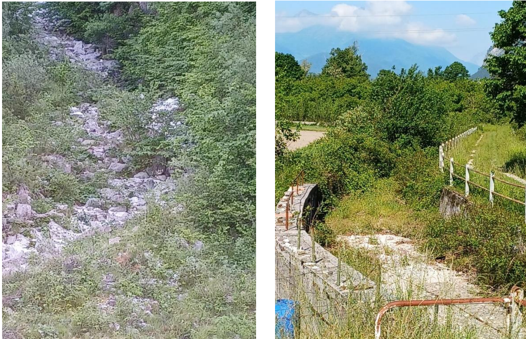
Rio Gridezzo – argini e alveo infestati dalla vegetazione
