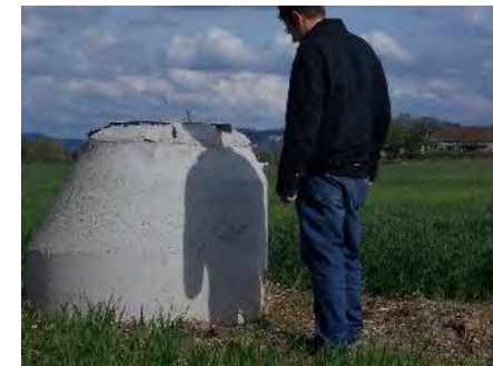
foto - pozzetto scolmatore
