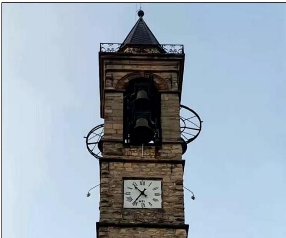
Figura 28 – Campanile della chiesa parrocchiale di Pedrengo Danneggiato dal fulmine del 26 settembre 2021
