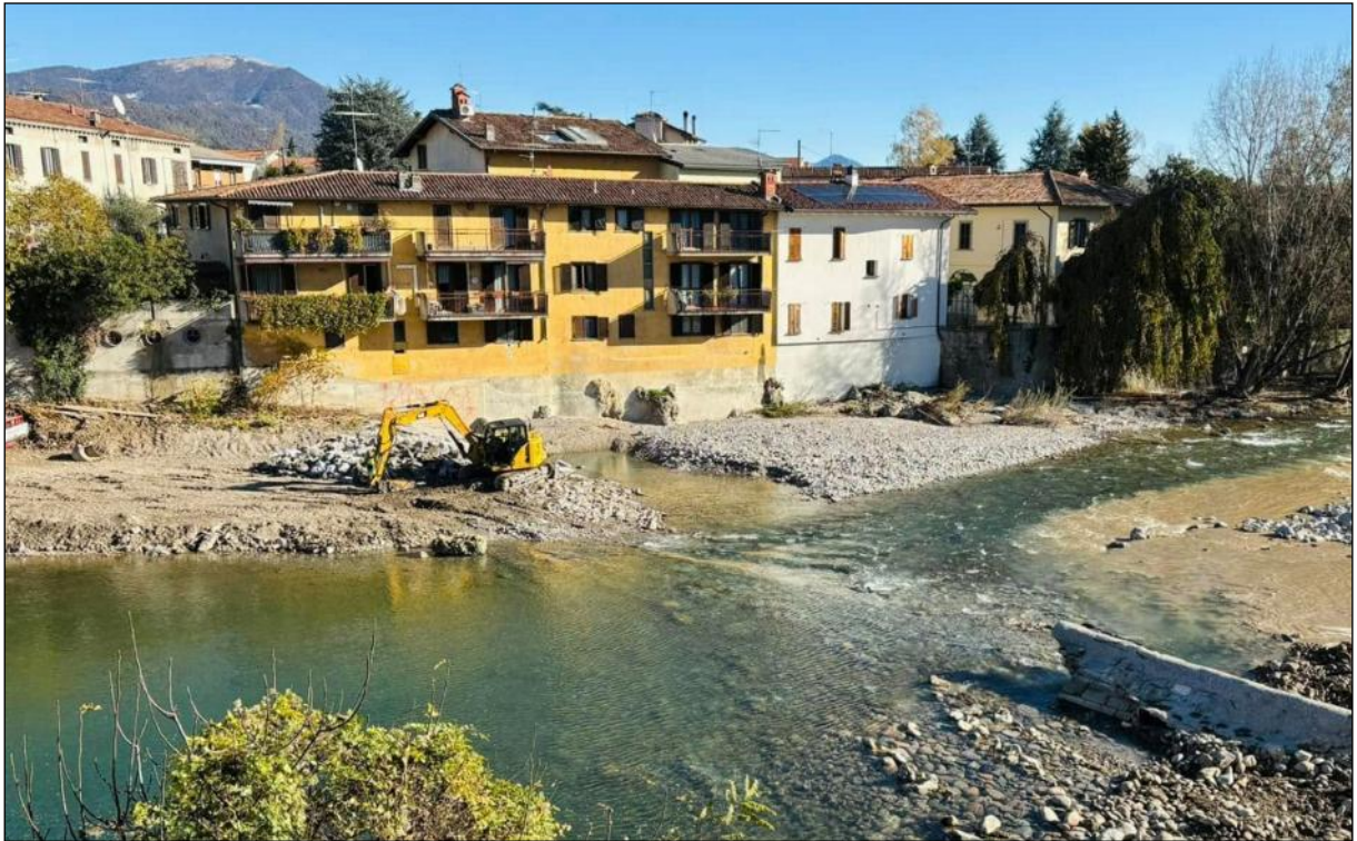
Figura 6 – Lavori di ripristino della soglia ex opera di presa della roggia Ponte perduto (ripresa da monte)
