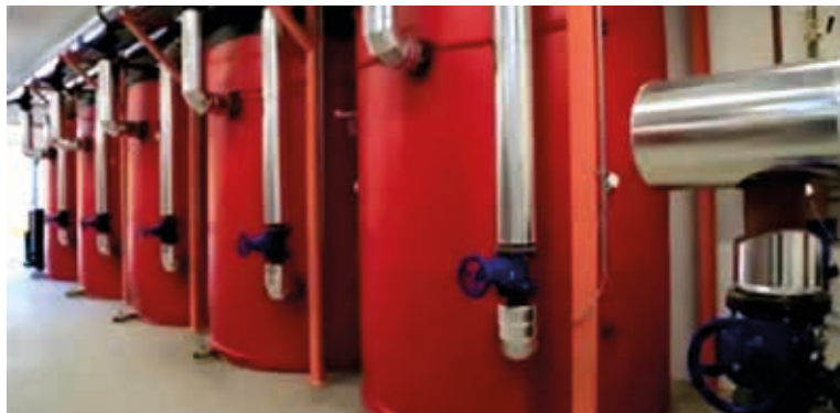
L'interno della centrale a biomassa
