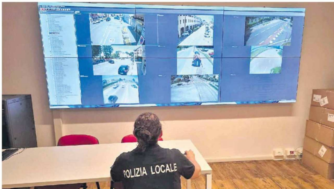
SICUREZZA Una sala della nuova Smart control room messa a disposizione della polizia locale dell'Unione dei Comuni del Miranese
