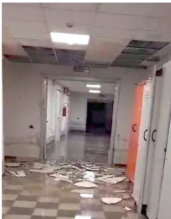
I pezzi di controsoffitto crollati al Mariutto
