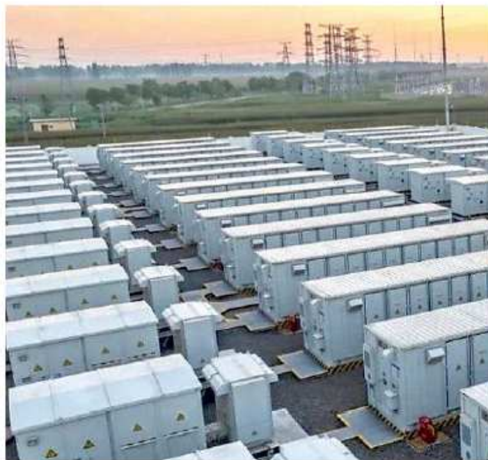
Una centrale Bess di accumulo elettrico
