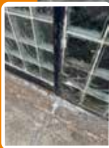
Finestre danneggiate che consentono la penetrazione dell'acqua e difficili da azionare
