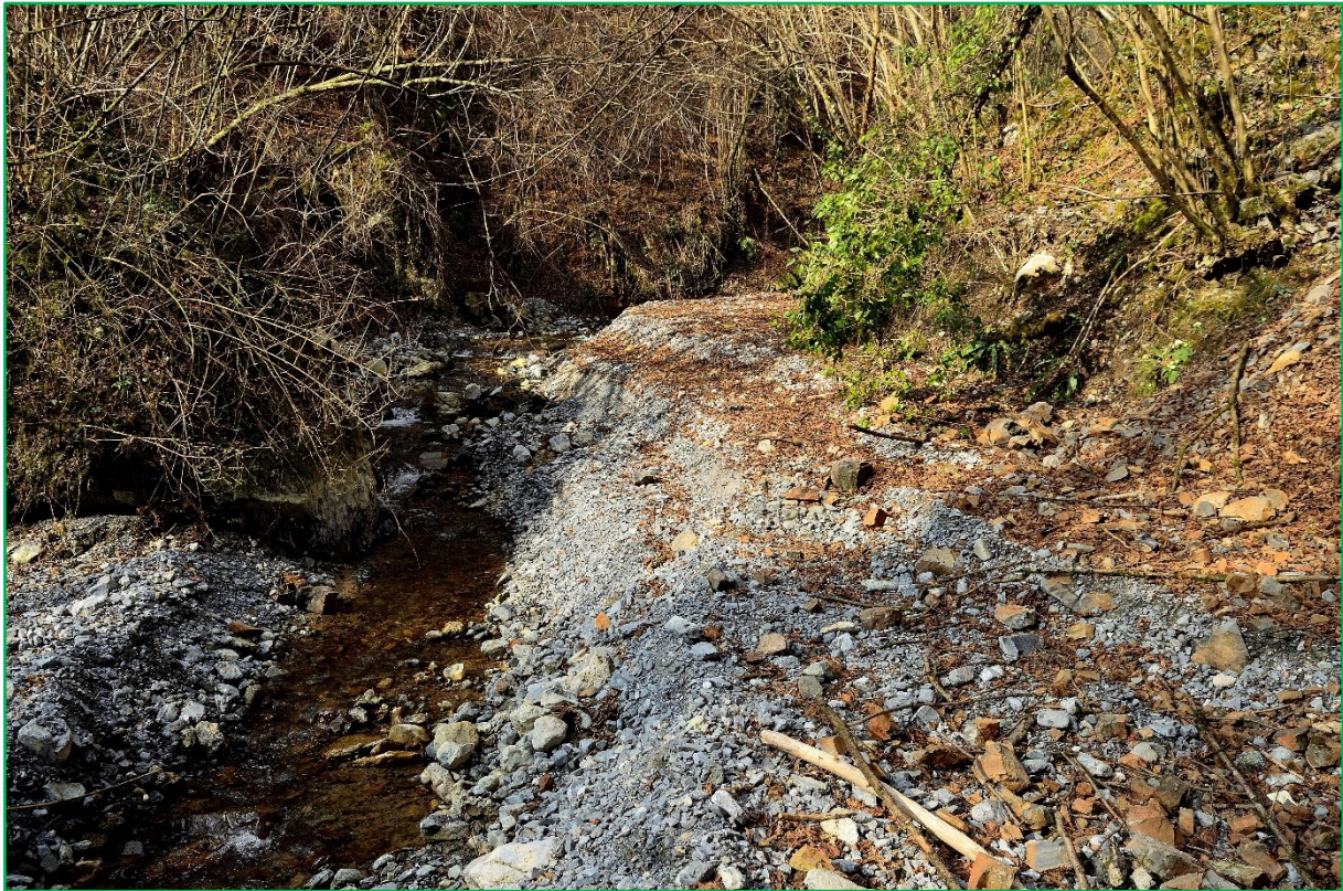
Figura 60 – Sovralluvionamenti nel tratto basso della Val Tinella, poco a monte degli Opifici, evidente segnale di trasporto solido ingente anche in occasione di eventi meteorici relativamente ordinari
