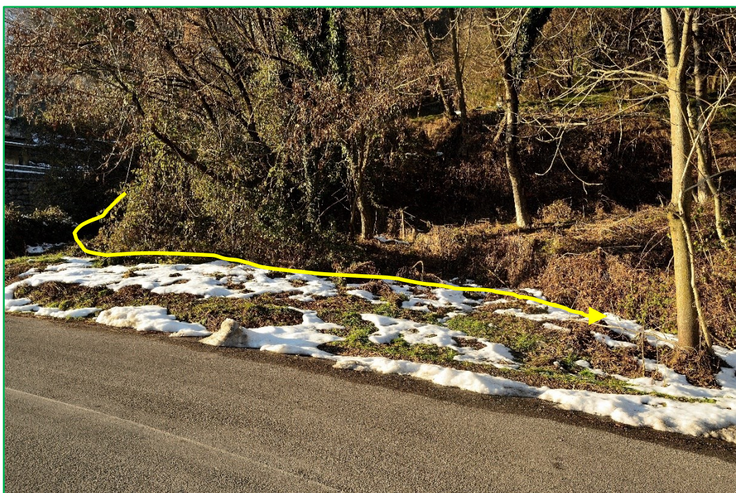
Figura 44 – Punto critico ATT_02 alla “Bretella del Farno”: la valletta devia di circa 90° e segue una modestissima incisione fino a re-immettersi in un tombotto ostruito dalla vegetazione; il dislivello rispetto alla sede stradale è molto limitato e potrebbe dare luogo ad esondazioni
