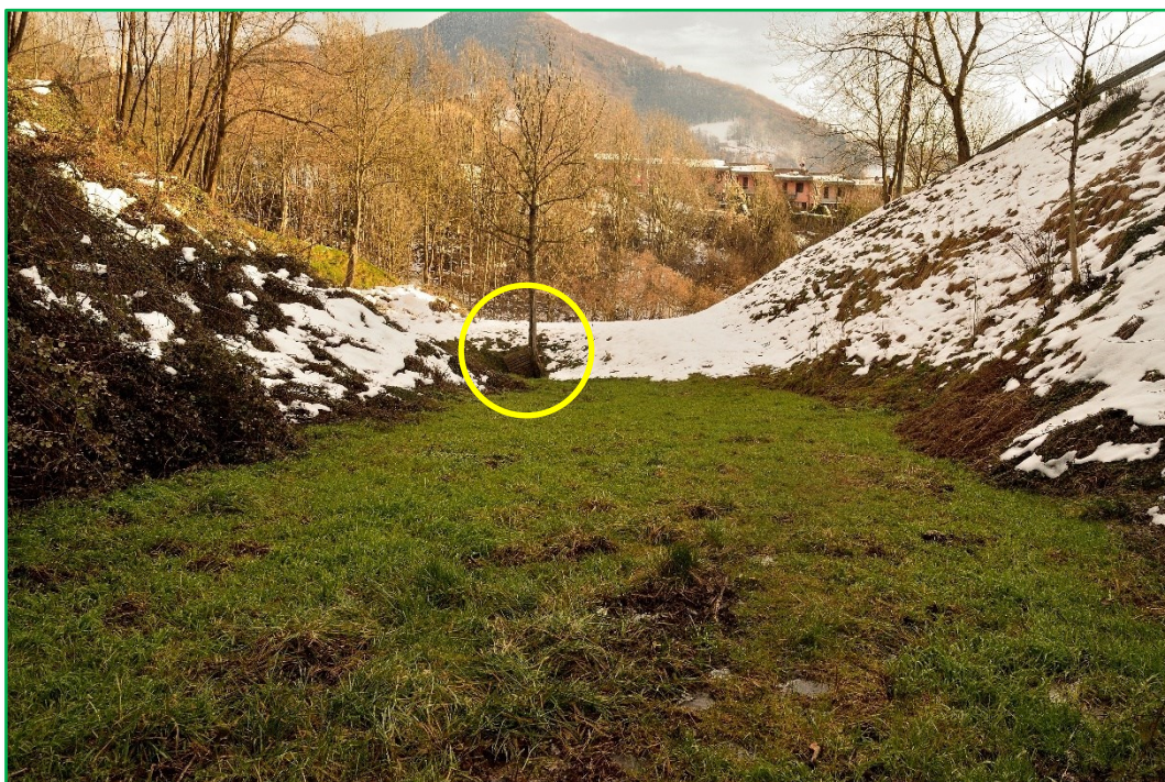
Figura 46 – Imbocco ostruito del tombotto finale presso la Cascina Campana
