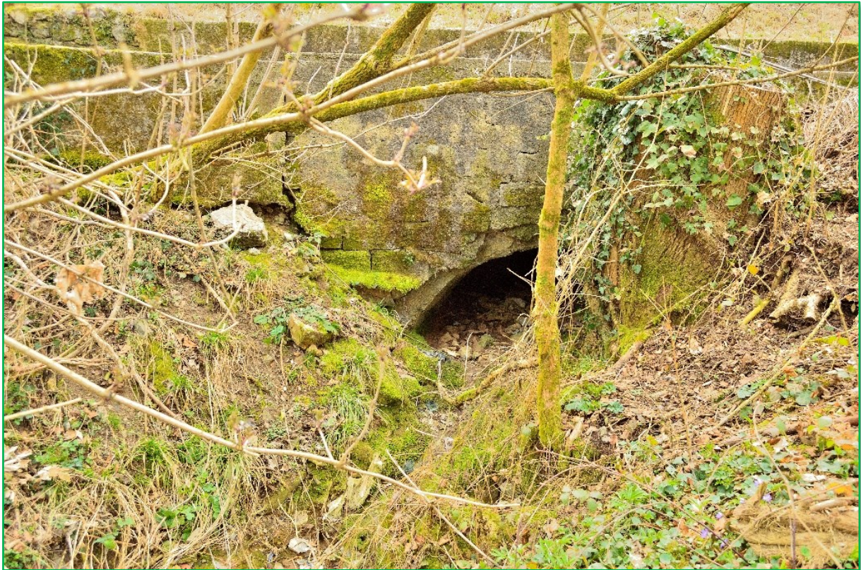
Figura 65 - Tombotto ammalorato e parzialmente ostruito al di sotto di Via Santa Elisabetta
