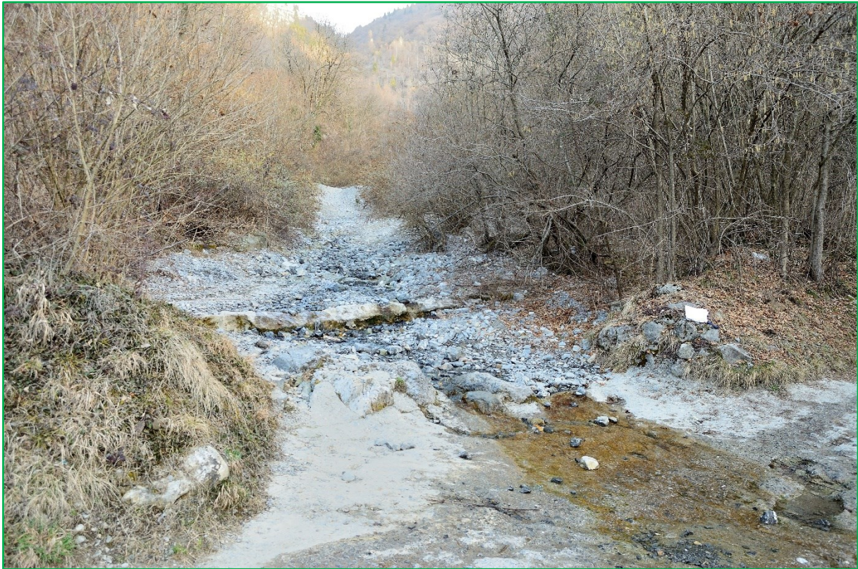
Figura 57 - La Val Groaro all'intersezione con la strada di Val d'Agro in località Groaro Il guado, oltre ad essere ammalorato, è completamente esposto ad eventuali fenomeni di debris flow, oltre che meramente esondativi
