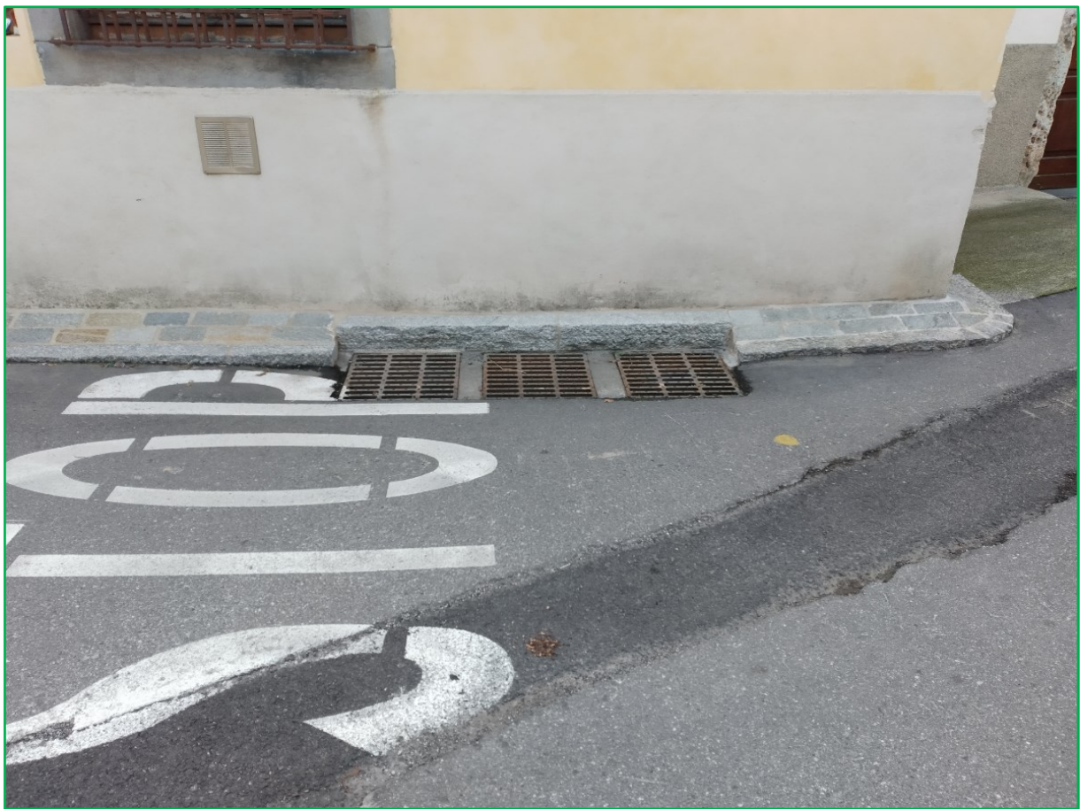
Figura 72 - Caditoie stradali poste sul lato posteriore della chiesa, all'inizio di Via Monte Grappa
