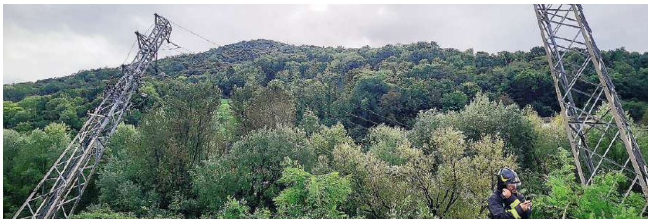
Il forte vento e la caduta degli alberi nei mesi di luglio 2024 e 2025 aveva messo alla prova alcuni tralicci e la rete elettrica di media tensione, con disagi e problematiche dalla Bassa alle Valli
