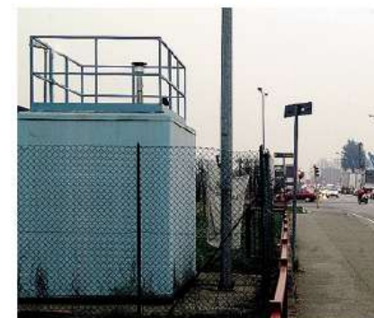
La centralina di rilevamento Pm10 a Dalmine
