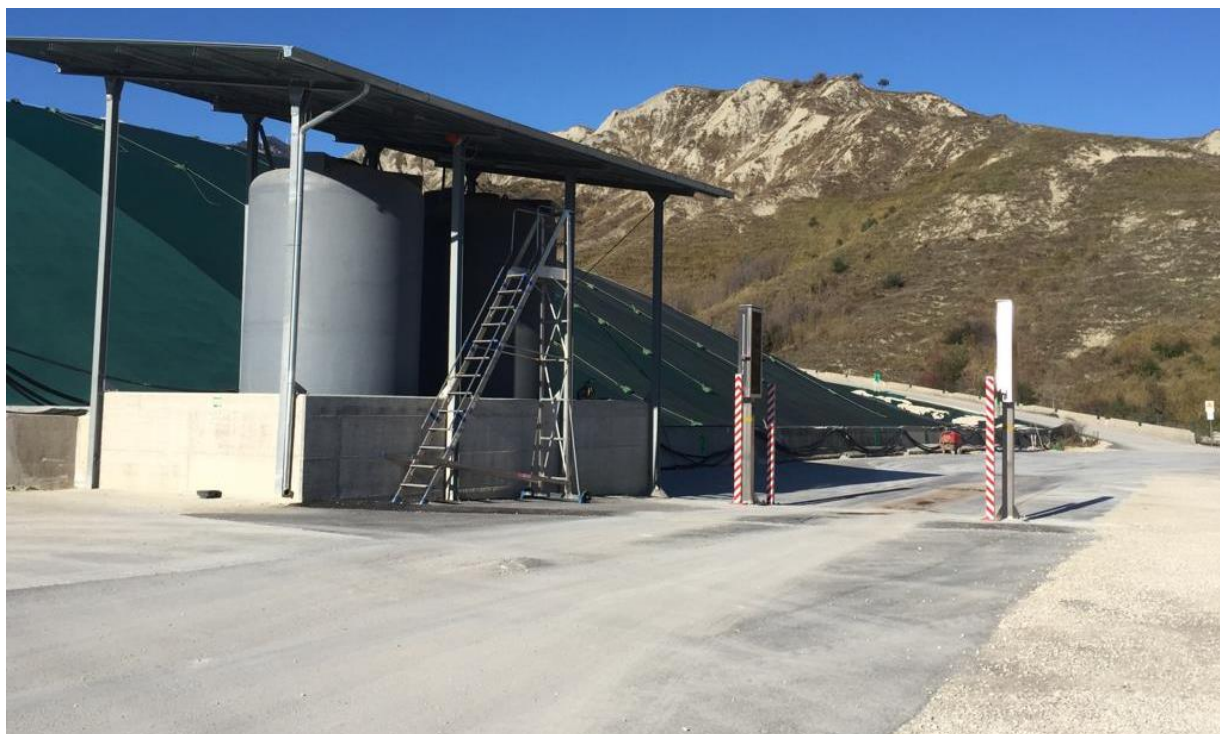
Figura 9 – Foto n. 9 – Piazzale pesa, serbatoi raccolta percolato da RSU sotto tettoia
