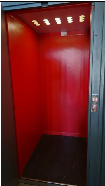
Montacarichi collegamento piano terra/primo piano
