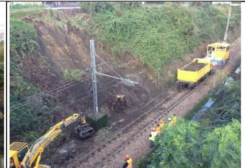
Foto – Frana Germignaga su ferrovia – 2014 – fonte varesenews
