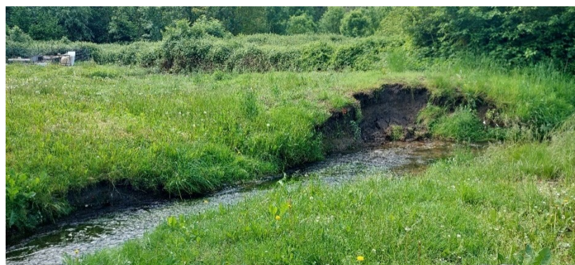
Foto – Erosione spondale in località Mulino dei Frati – derivazione torrente Viganella– 05/2024
